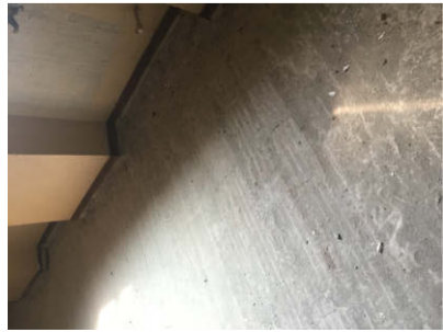
2 PORZIONI PAVIMENTAZIONE ASSENTE (ANNO 1985)
