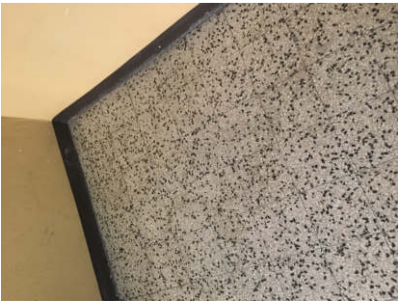
4 PAVIMENTI IN GRANIGLIA DA SOSTITUIRE (ANNO '70/80)
