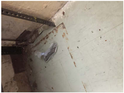
3 PAVIMENTI VINICI DA SOSTITUIRE (ANNO '90/95)
