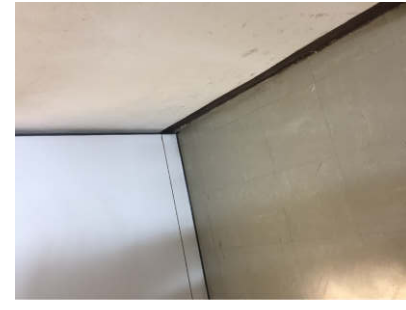
3 PAVIMENTI VINILICI DA SOSTITUIRE (art. 30/90)
