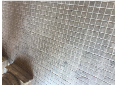
1 PAVIMENTI IN CEMENTO DA SOSTITUIRE (art. 30/90)
