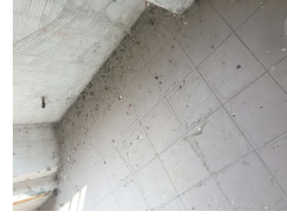
5 PAVIMENTI IN CERAMICA DA SOSTITUIRE (art. 30/90)
